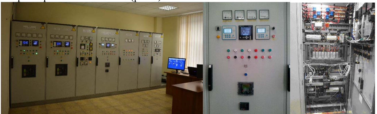
Рис. 3 – 7 із 14 секцій ГРЩ повномасштабного тренажерного комплексу та секція керування асинхронним валогенератором і реактивною потужністю СЕЕС
