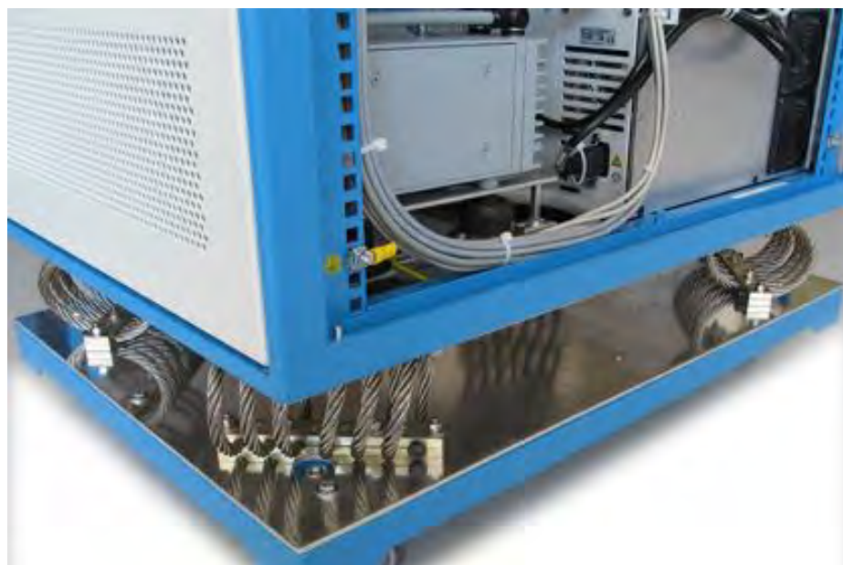
Рисунок Г.2 – Блок електронної техніки дослідної станції для вивчення ураганів встановлений на канатних віброізоляторах
