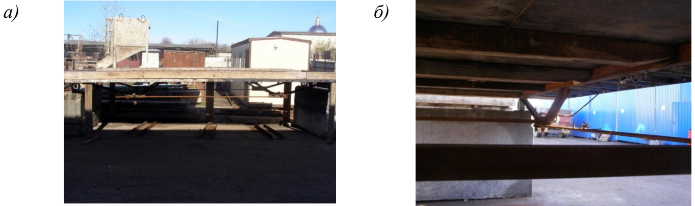
Рис. 4.4. Експериментальна модель комбінованої сталезалізобетонної попередньо напруженої шпренгельної конструкції на стадії її виготовлення: а – поздовжній вигляд; б – вигляд знизу
