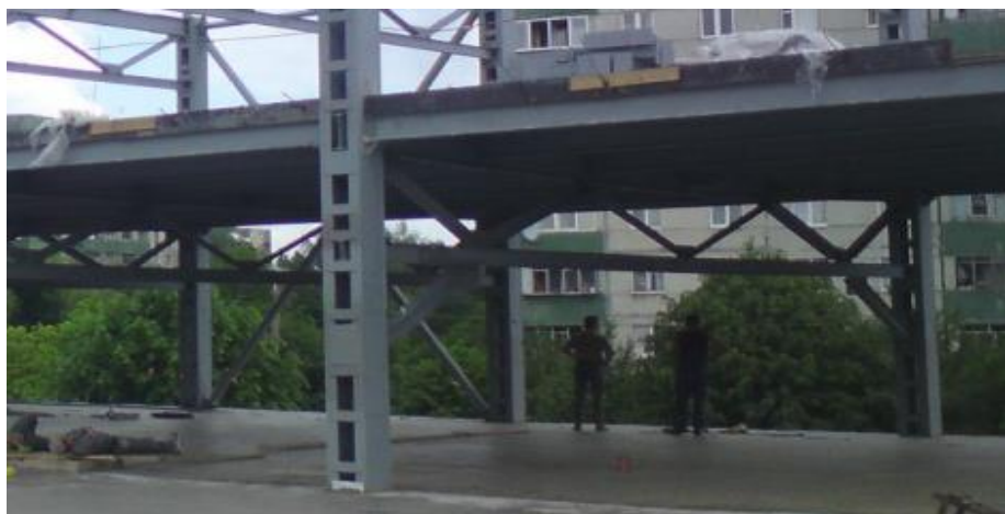
Рис. 4.49. Використання комбінованих сталезалізобетонних ПНШК при влаштуванні перекриття будівлі «Таврія-В» (м. Львів, вул. Зубрівська, 38)
