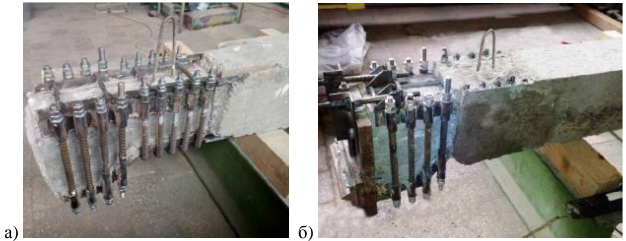
Рис. 2.19. Підсилення консолей зразка КП-03-0,0: а) влаштування металеві обойми; б) відновлення залізобетонної обойми до проектних розмірів
