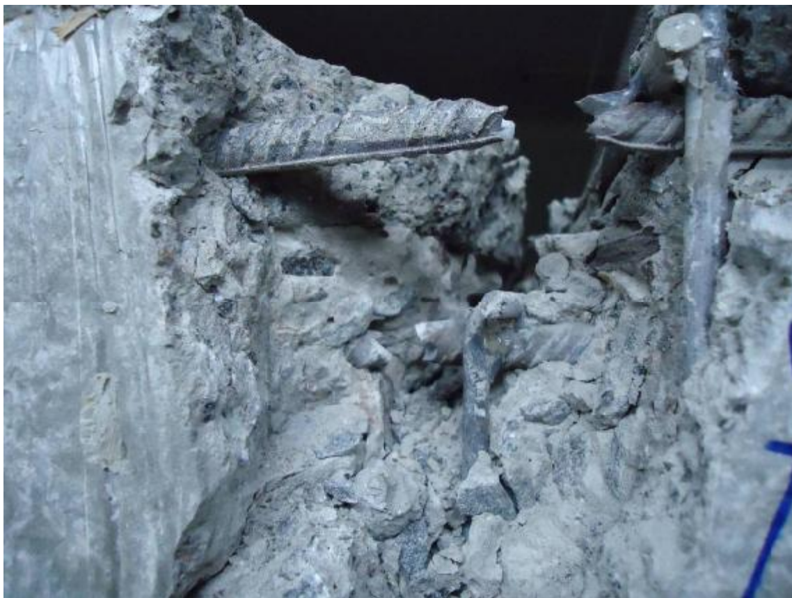
Рис. 3.14. Розрив обох шарів розтягнутої поздовжньої арматури колони КП-11-0,9
