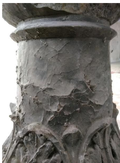
Рис. 4.1.2.27. Розшарування, тріщини та забруднення на поверхні опори алебастрової хрестильниці
