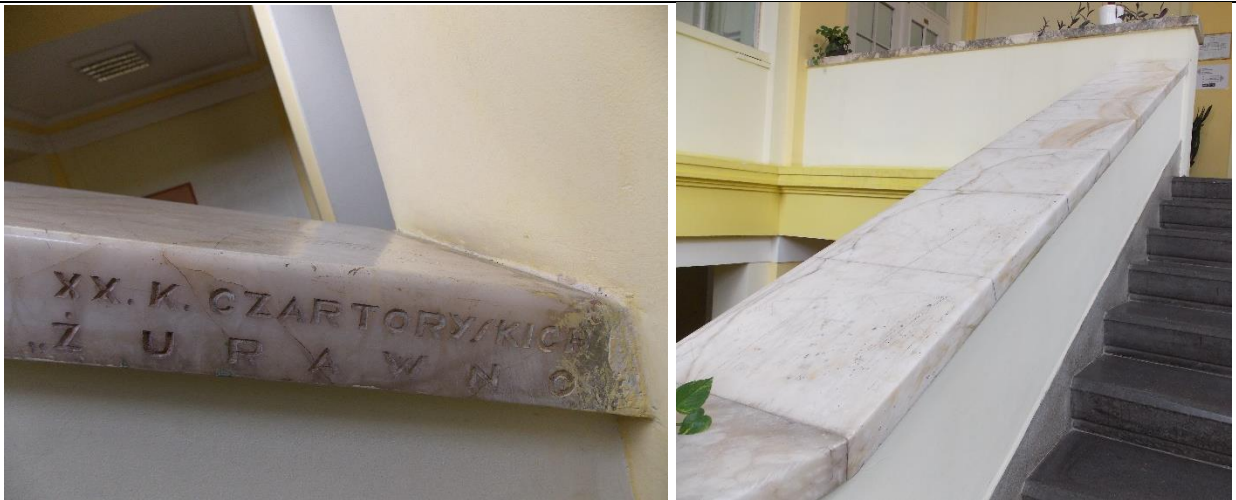
Перила сходової клітки у вестибюлі науково-технічної бібліотеки НУ «Львівська політехніка», м. Львів
