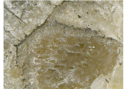
Рис. 4.1.2.21. Розтріскування кристалічної маси та заповнення тріщин забрудненнями
