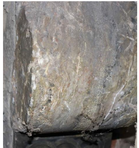
Рис.4.1.1.6. Надгробок Анни Сенявської у Бережанському замку, м. Бережани. Процес вивітрювання каменю. Соляні відклади. Розчинення кристалічної маси. Дрібні тріщини
