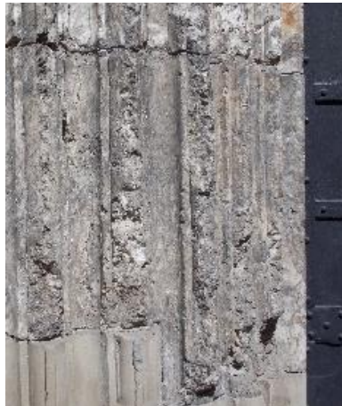
Рис.4.1.1.26. Алебастровий портал костелу Успіння Пресвятої Діви Марії, св. Христа і св. Варфоломія в м. Дрогобич. Блок № 3. Механічні пошкодження. Процес вимивання. Атмосферні забруднення
