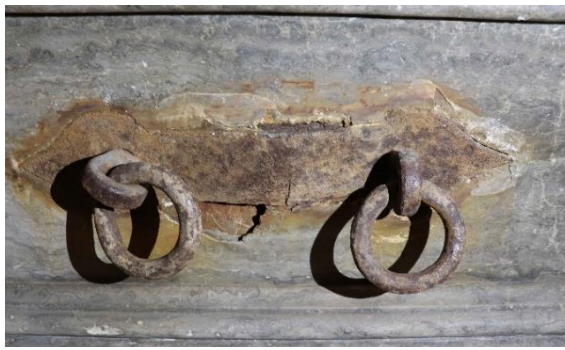
Рис.4.1.1.8. Саркофаг Миколи Вижицького у Музеї підземелля Гарнізонного храму св. ап. Петра і Павла, м. Львів. Ураження іржею, розшарування каменю. Зміна забарвлення. Тріщини та сколи
