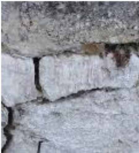
Рис.4.1.1.22. Фрагмент фундаменту церкви Успіння Пресвятої Богородиці, с. Крилос, Івано-Франківська область. Процес вивітрювання, вимивання з утворення борозен, розчинення та перекристалізації кристалічної маси
