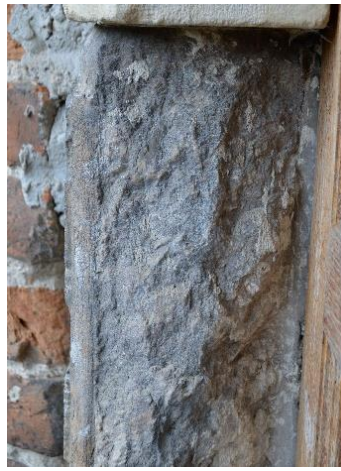
Рис.4.1.1.29. Віконні обрамлення каплиці Снопковських («Аріанська вежа»), м. Белз, Львівська область. Процес розчинення кристалічної маси
