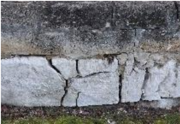
Рис.4.1.1.20. Фрагмент фундаменту церкви Успіння Пресвятої Богородиці, с. Крилос, Івано-Франківська область. Механічні пошкодження: розтріскування внаслідок механічного тиску верхніх блоків та ослаблення структури каменю
