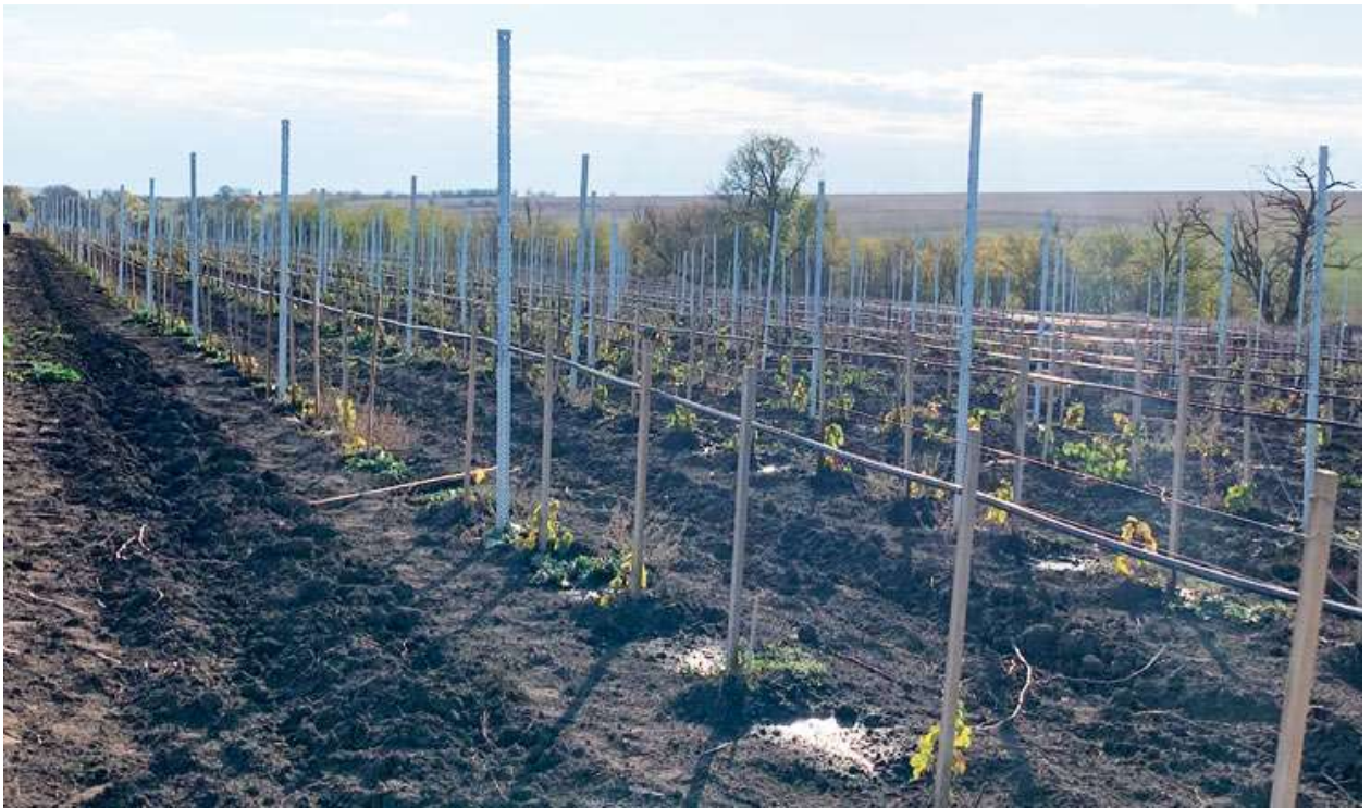
Рис. 5.7. Система крапельного зрошення виноградника (горизонтальні поливні трубопроводи закріплено на вертикальних стержнях, які служать опорами для розвинених виноградних кущів; світлина взято з сайту https://agrotimes.ua/article/rezhymna-terytoriya/ )
