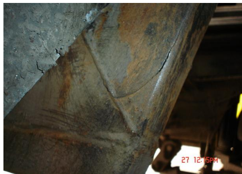
Рисунок 2.9 – Втомна тріщина каркасу основи кузова в задній частині
