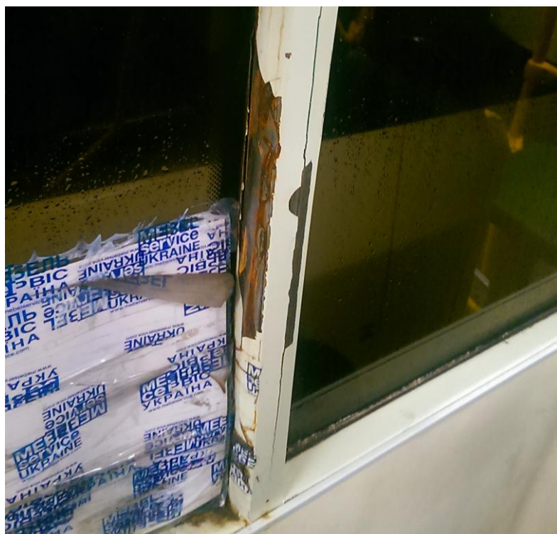
Рисунок 4.33 – Пошкоджена стійка, що підлягає обов’язковій заміні
